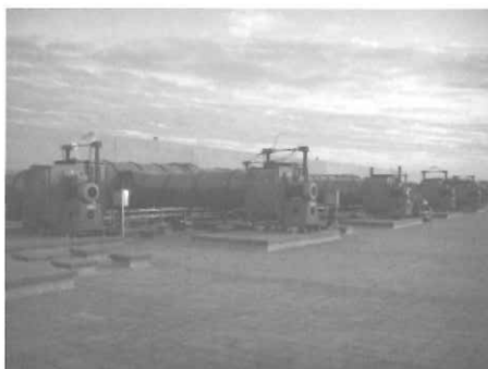
圖7 台灣台中友達光電廠出風口電力回收系統應用
